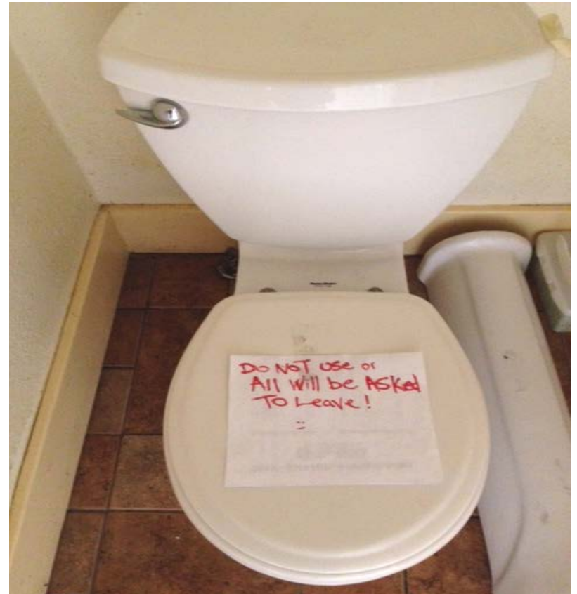
Non Functioning Bathroom
