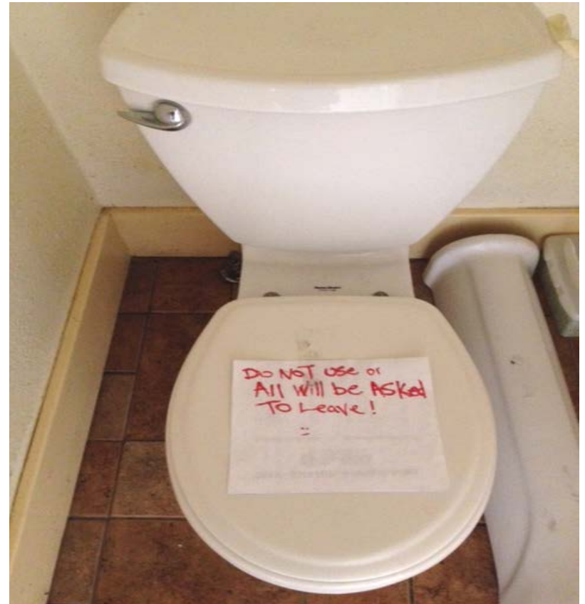
Non Functioning Bathroom
